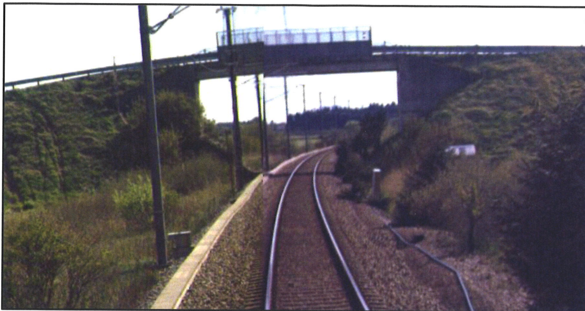
Figur 30 Konstruksjon ved dagens kryssing med Torlandsvegen (km. 563,961). Bilde i sørlig retning. Kilde: Målevognsbilde (mot Oslo).
