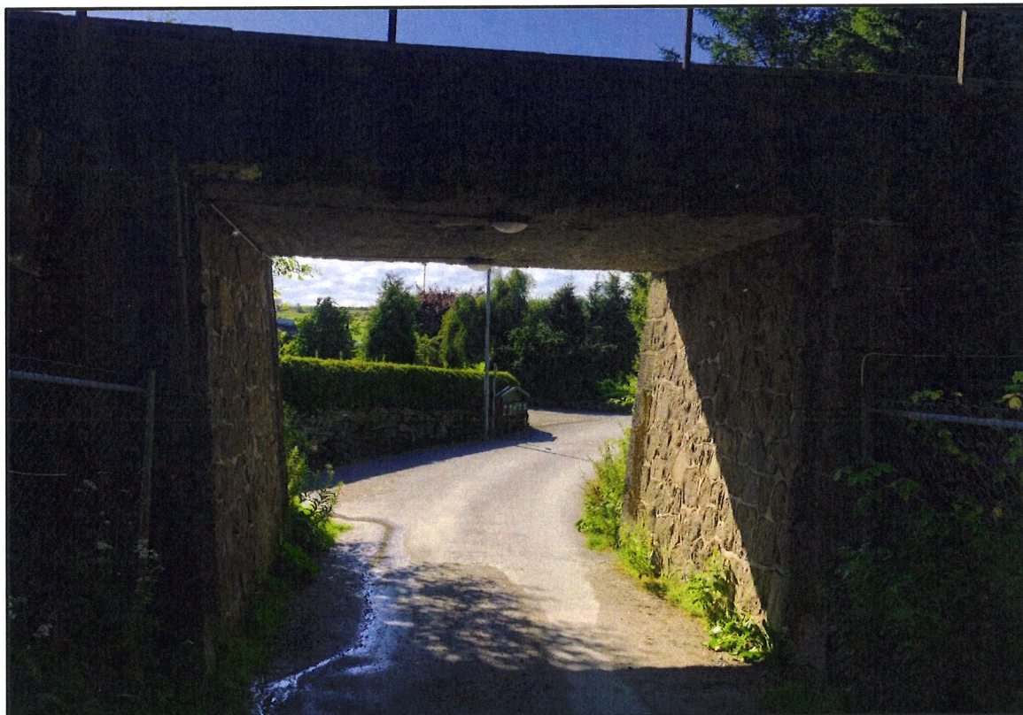
Figur 50 Konstruksjon ved dagens driftskryssing (km. 573,576). Bilde i vestlig retning. Kilde: Jakob Bitsch Jensen (befaring 2020-08-06).
