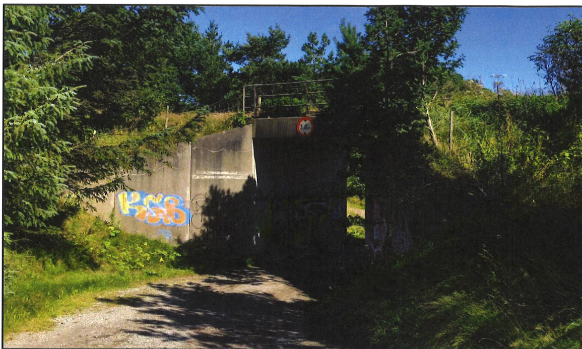
Figur 48 Konstruksjon ved dagens driftskryssing (km. 570,802). Bilde i østlig retning. Kilde: Jakob Bitsch Jensen (befaring 2020-08-06).
