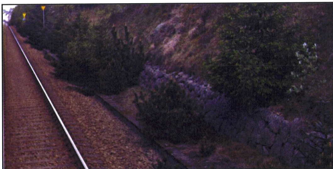
Figur 38 Dagens løsning med tørrmur i bunnen av løsmasseskjæring på østlig side av spor (km. 568,160). Bilde i nordlig retning. Kilde: Målevognsbilde (fra Oslo).
