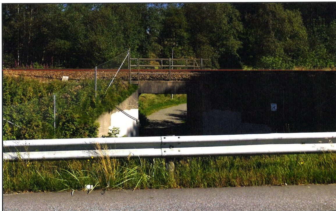
Figur 47 Konstruksjon ved dagens kryssing for gang- og sykkelveg (km. 570,348). Bilde i østlig retning. Kilde: Jakob Bitsch Jensen (befaring 2020-08-06).
