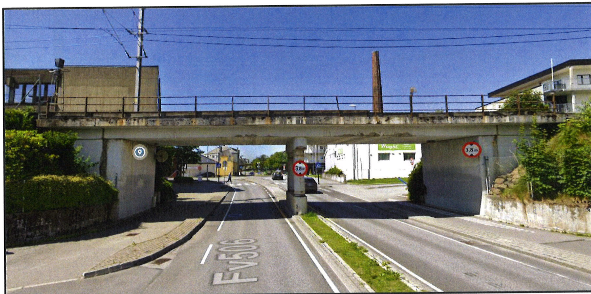
Figur 42 Konstruksjon ved dagens kryssing med Arne Garborgs veg (km. 569,426). Bilde i vestlig retning. Kilde: Google Streetview (2019).
