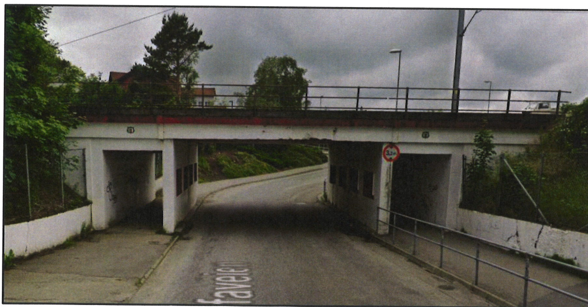
Figur 41 Konstruksjon ved dagens kryssing med Trallfavegen (km. 568,848). Bilde i vestlig retning. Kilde: Google Streetview (2019).
