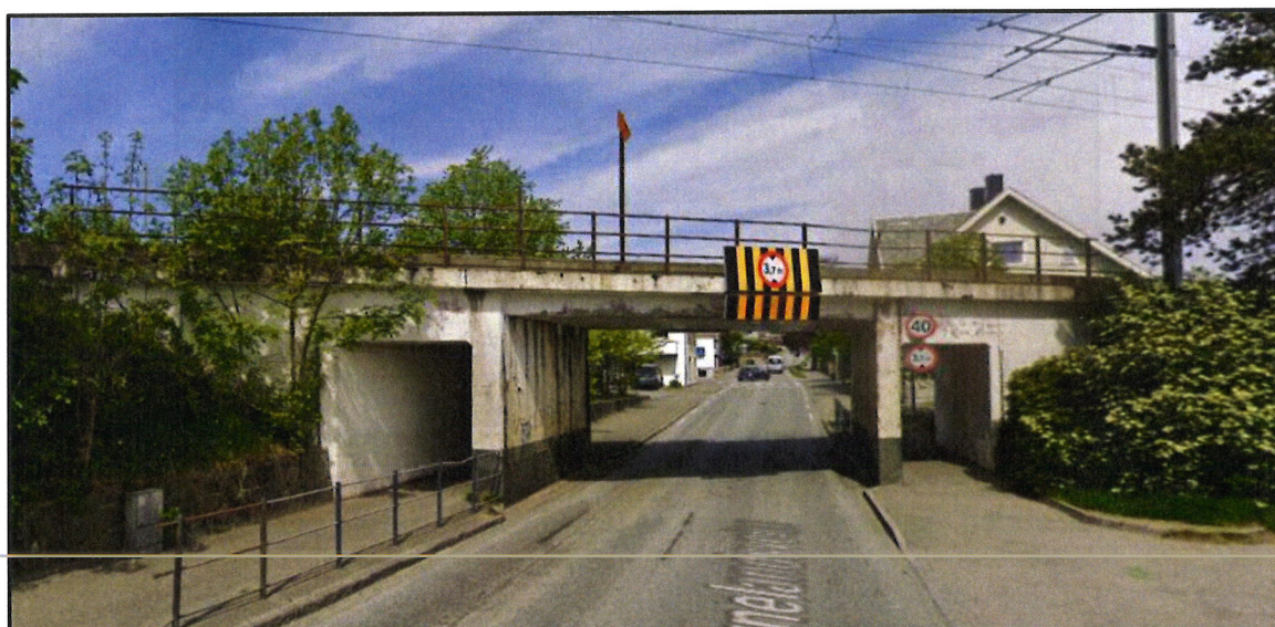
Figur 78 Konstruksjon ved dagens kryssing med Kvernelandsveien (km. 580,427). Bilde i vestlig retning. Kilde: Google Streetview (2019).
