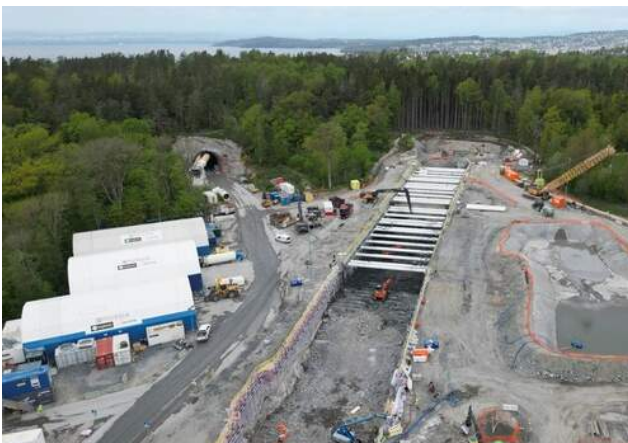
Tunnelpåhugget kommer øverst i kulverten, cirka 32 meter under terrengnivå. Foto: Øystein Stavdal Paulsen, Bane NOR.
