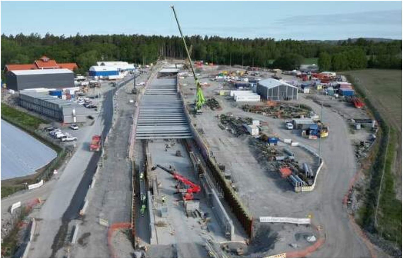
Betongarbeidene er kommet langt i kulverten på Carlberg. Foto: Øystein Stavdal Paulsen, Bane NOR.
