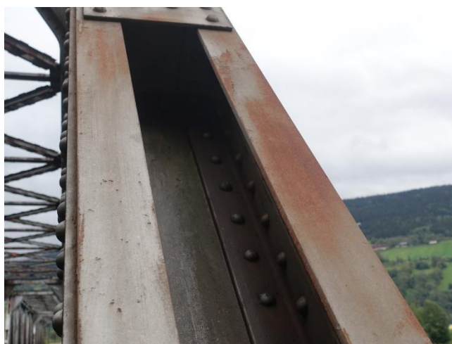
Foto nr. 16: Korrosjon.
