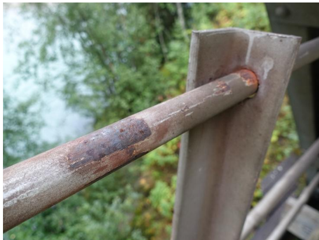
Foto nr. 26: Korrosjon.
