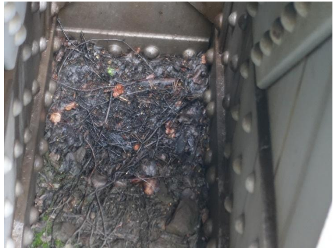
Foto nr. 20: Manglende rengjøring.
