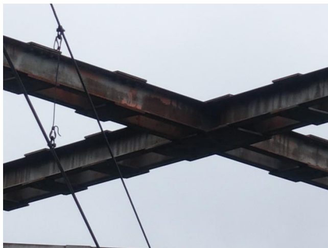
Foto nr. 14: Korrosjon.
