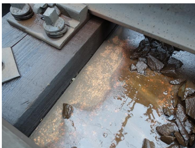
Foto nr. 18: Korrosjon.
