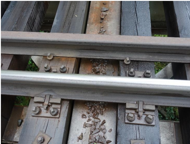
Foto nr. 19: Manglende rengjøring.
