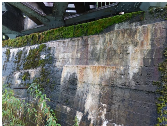
Foto nr. 3: Riss med kalk.
