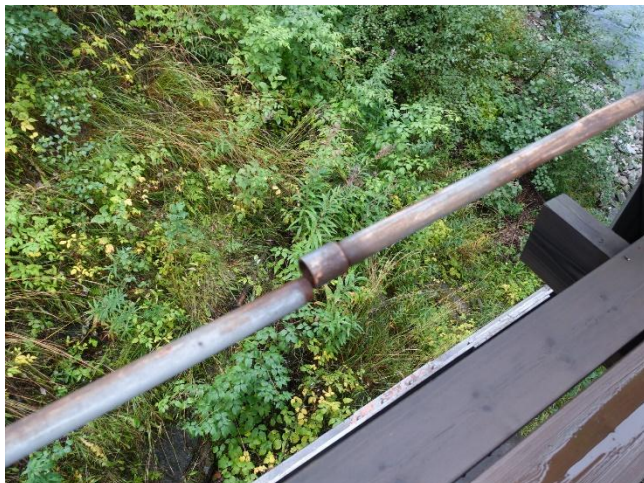
Foto nr. 25: Brudd i rekkverksrør.
