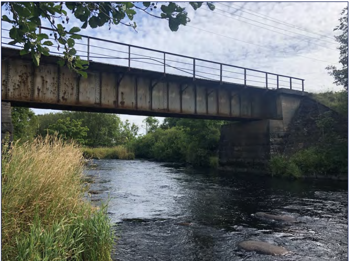
Figur 69: Hååna ved eksisterende vegbru for fv. 4388 Njølstadvegen
