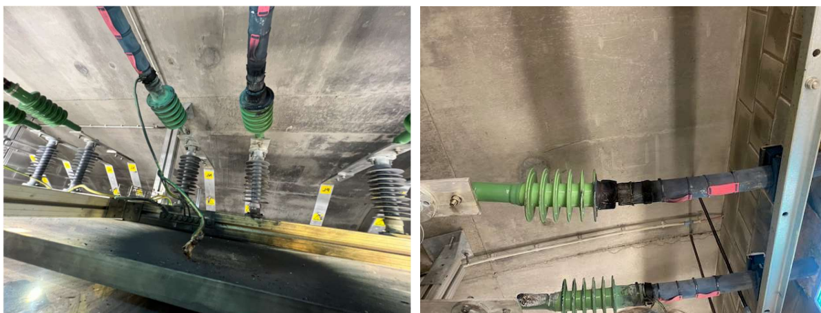
Figur 13 Avbrent utjevning mellom skjerm i negativ fase og jord.
