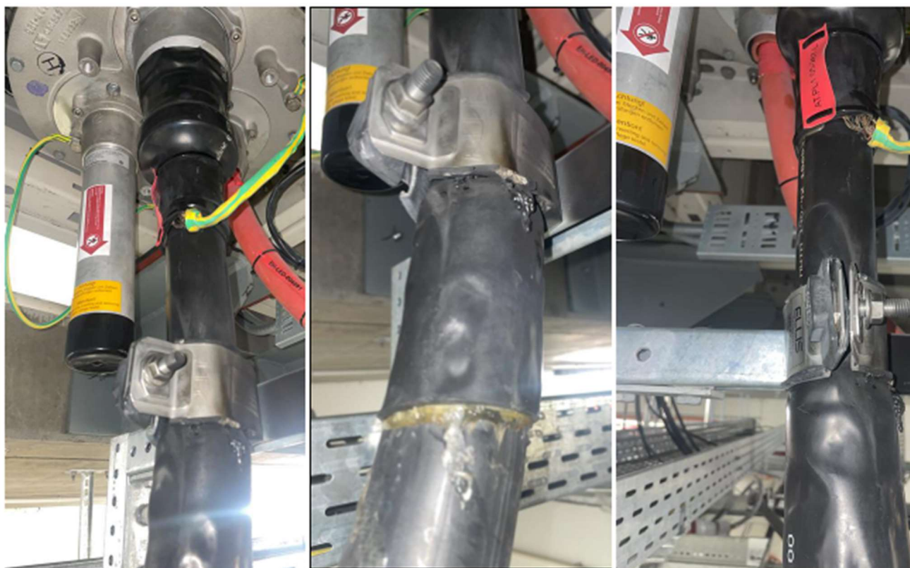
Figur 9 Stram klamring av kabel. Endeavslutningen på bildet er den som også er vist i Figur 7. Bildet er fra positiv fase for sporet Ski-Oslo i Ski koblingshus.
