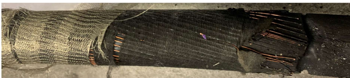
Figur 7 Ytterkappe på endeavslutning er tatt av og bildet viser til at alle kobbertrådene er brent av. Det sorte svellebandet er helt og hindret direkte elektrisk kontakt mellom skjermene. (Foto: SINTEF Energi AS)
