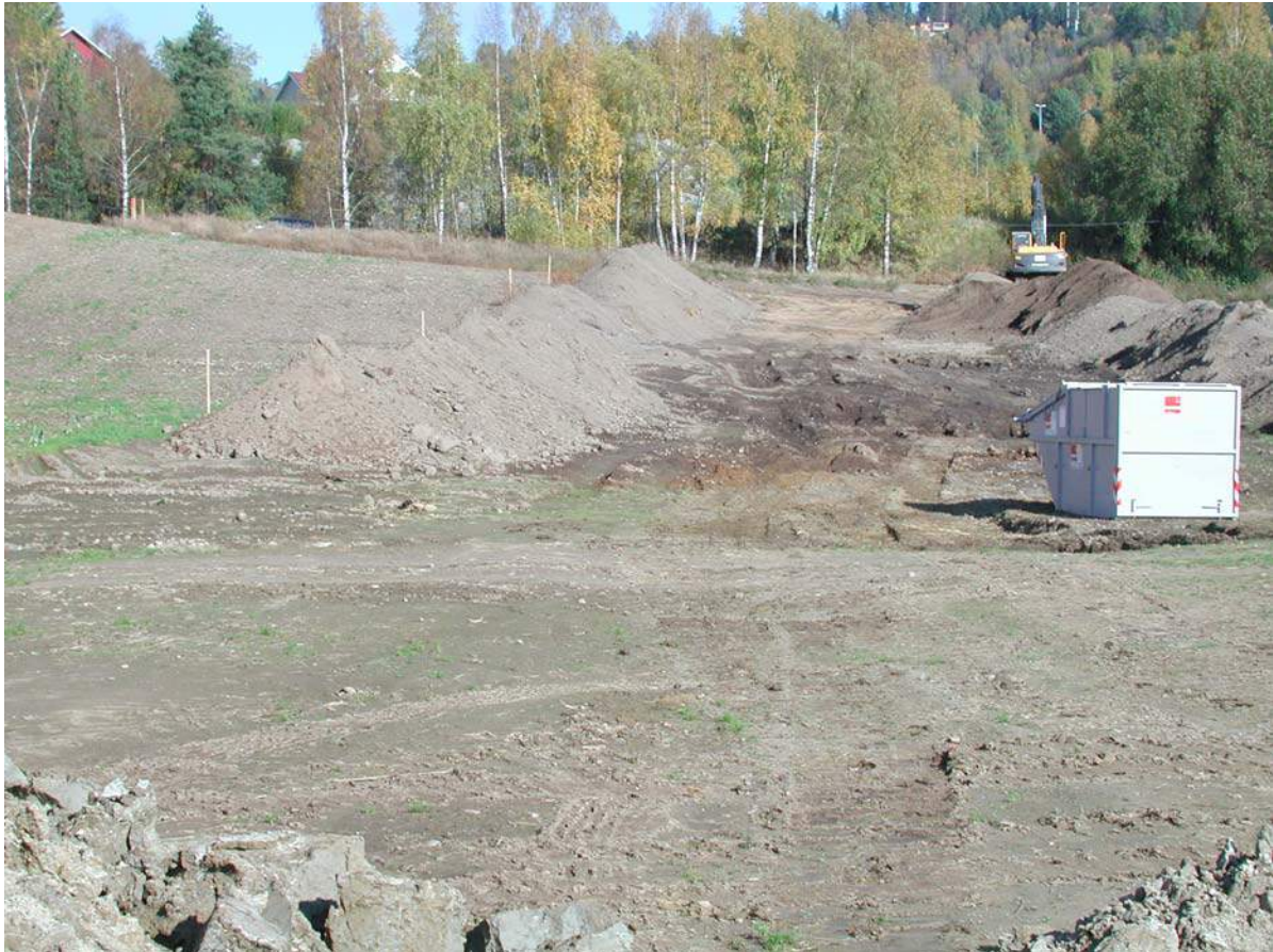
Figur 7-5: Ranker med jord er lagt opp på hver side av der hvor vannledningen skal graves. Matjord er ranket opp til venstre, og undergrunnsjord til høyre (Foto: Trond Knapp Haraldsen)
