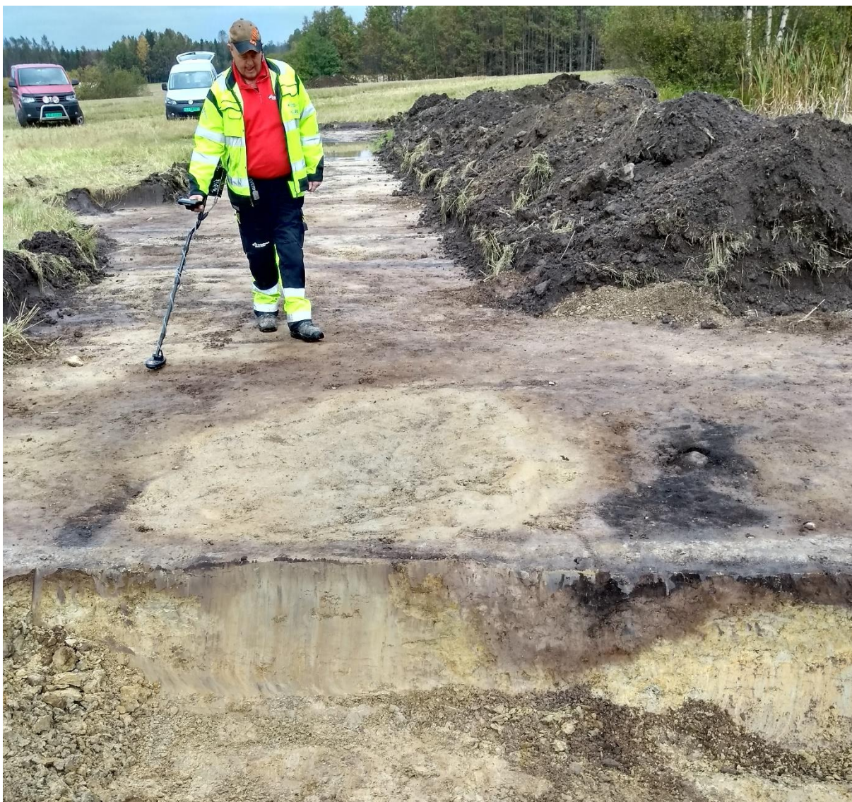
Figur 32. Bilde av ID 230968-1 fotgrøft etter snitting. Trekullprøve ble hentet ut av fyllmassene til høyre. Fotgrøften til venstre i bildet var forstyrret av en moderne grøft. På bildet maskinfører Per Christensen med metallsøker.
