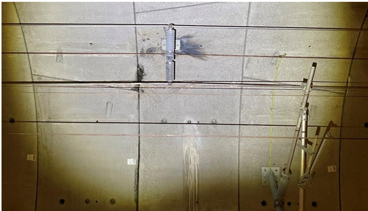
Figur 6: Bilde fra Teknisk årsaksresonnement viser kortslutningssted ved hengemast F-022-09. Retning Ski til venstre og retning Oslo til høyre.
