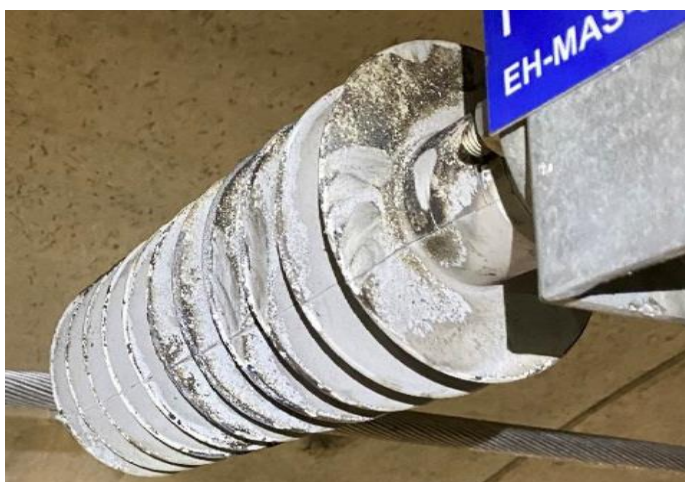
Figur 7: Bilde fra Teknisk årsaksresonnement viser isolator med hvitt og sort stoff på kortslutningsstedet
