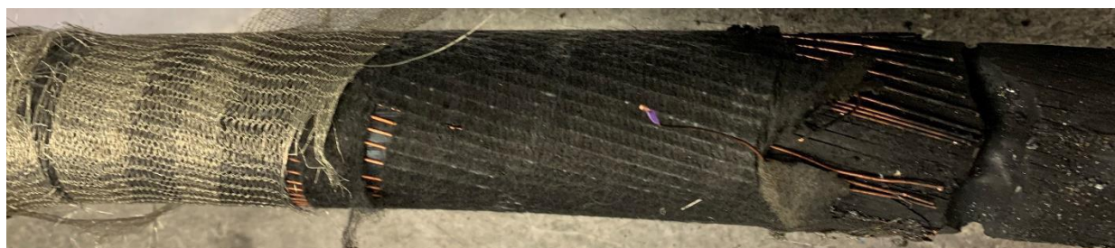
Figur 4: Bildet er tatt av Sintef Energi AS og viser kabelen uten kappe, hvor det er synlige skader etter varmgang
