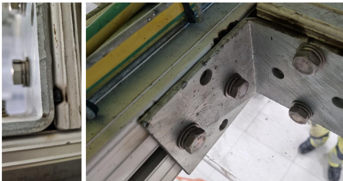
Figur 16 Brennmerker i skjøter og vinkler på aluminiumsbindeverket.
