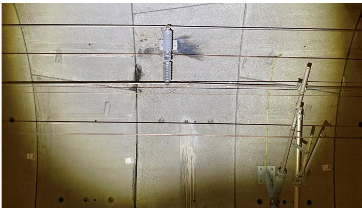
Figur 12 Kortslutningssted ved hengemast F-022-09. Retning Ski til venstre og retning Oslo til høyre.
