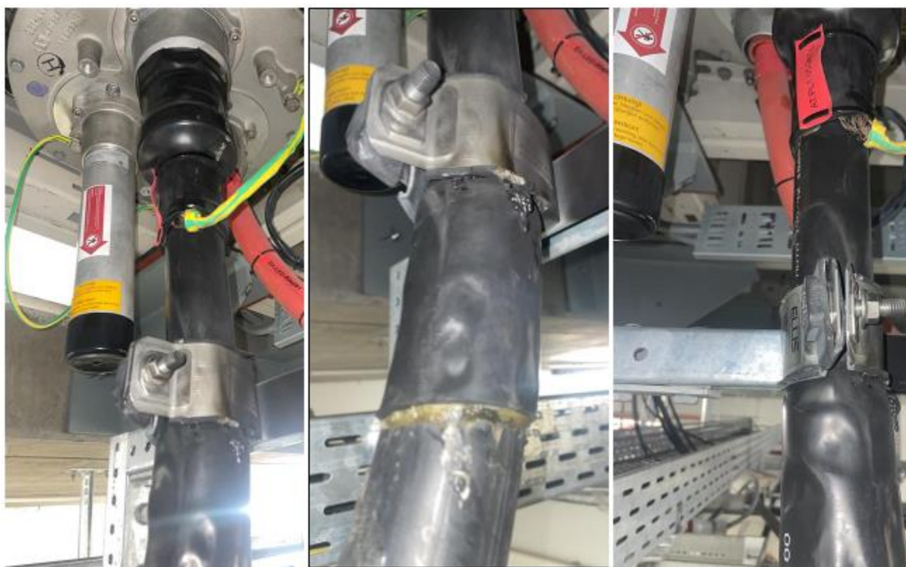
Figur 10 Stram klamring av kabel. Endeavslutningen på bildet er den som også er vist i Figur 7. Bildet er fra positiv fase for sporet Ski-Oslo i Ski koblingshus.
