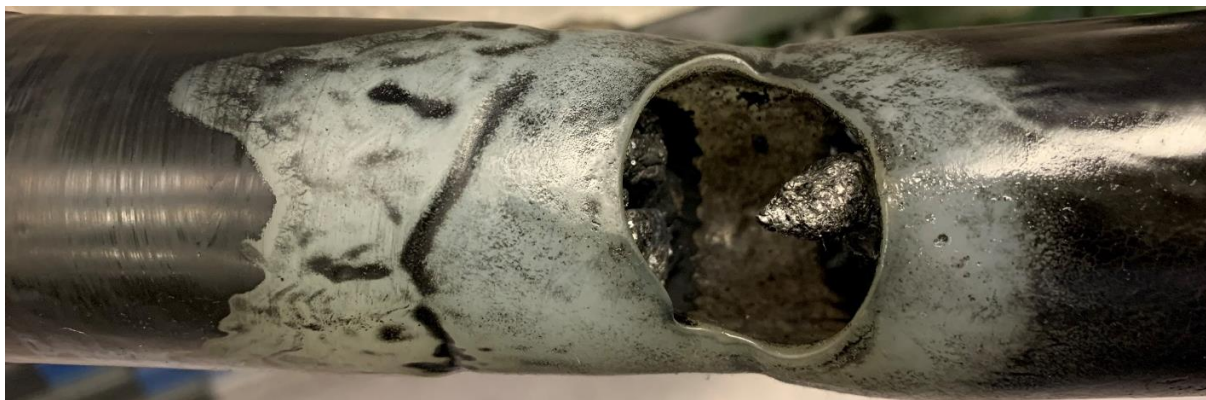
Figur 9 Ødelagt kabelisolasjon og senterleder (Foto: SINTEF Energi AS)
